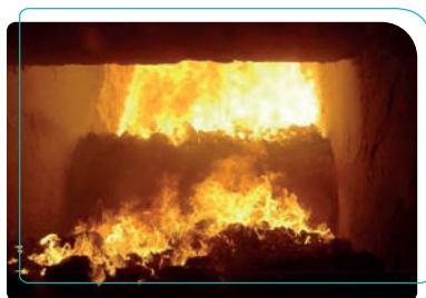
Incineration avec valorisation énergétique
